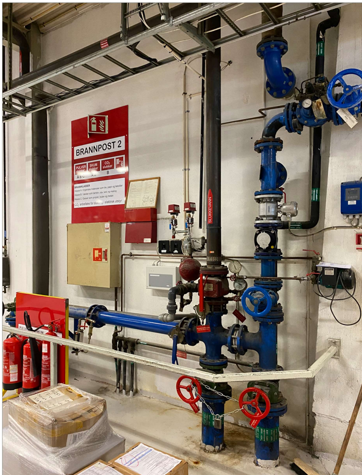
Eksempelbilde brannpost (Foto: SH Prosjekt)
