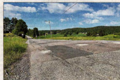
LYS: Det blir lysregulering når fylkesvei 115/Haldenveien skal utbedres mellom Nyveien og Hornsøngveien.
